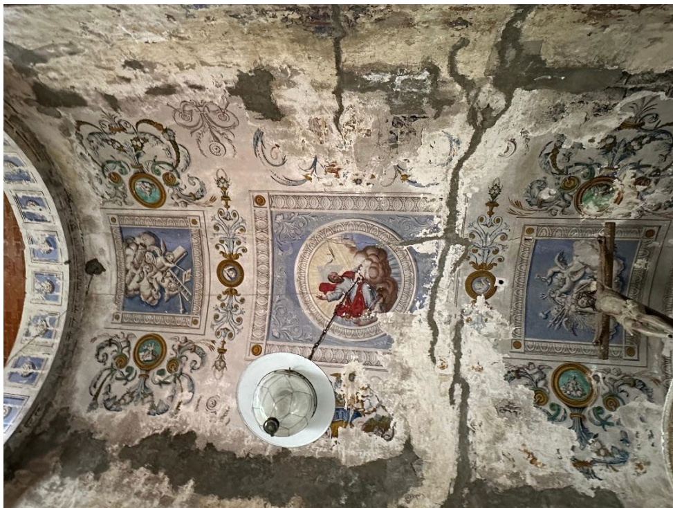
Imagen 55. Hacienda de Jaltipa. La Santísima Trinidad es la base del candil. Otras imágenes, sumamente deterioradas, muestran la representación de un Vía Crucis
