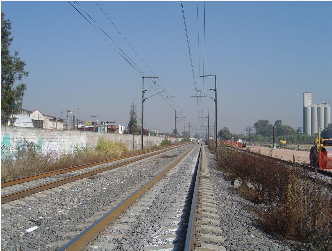
Imagen 128. Aspecto de la vía antes de iniciar la construcción de la estación Cuautitlán del Tren Suburbano (arriba), cimentación de la estación referida (abajo)
